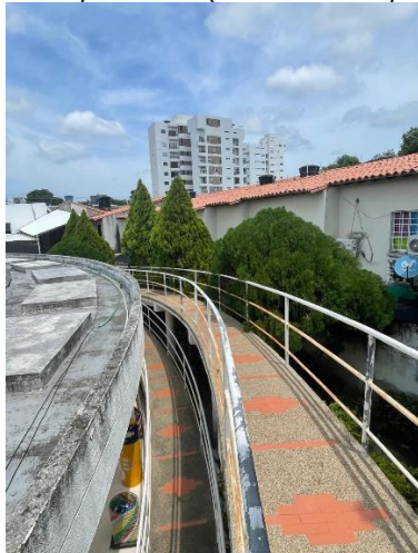
Ilustración 13 Rampa interna (Persiste incumplimiento)
