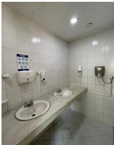
Ilustración 7 Lavamanos (Baños de mujeres y hombres)
